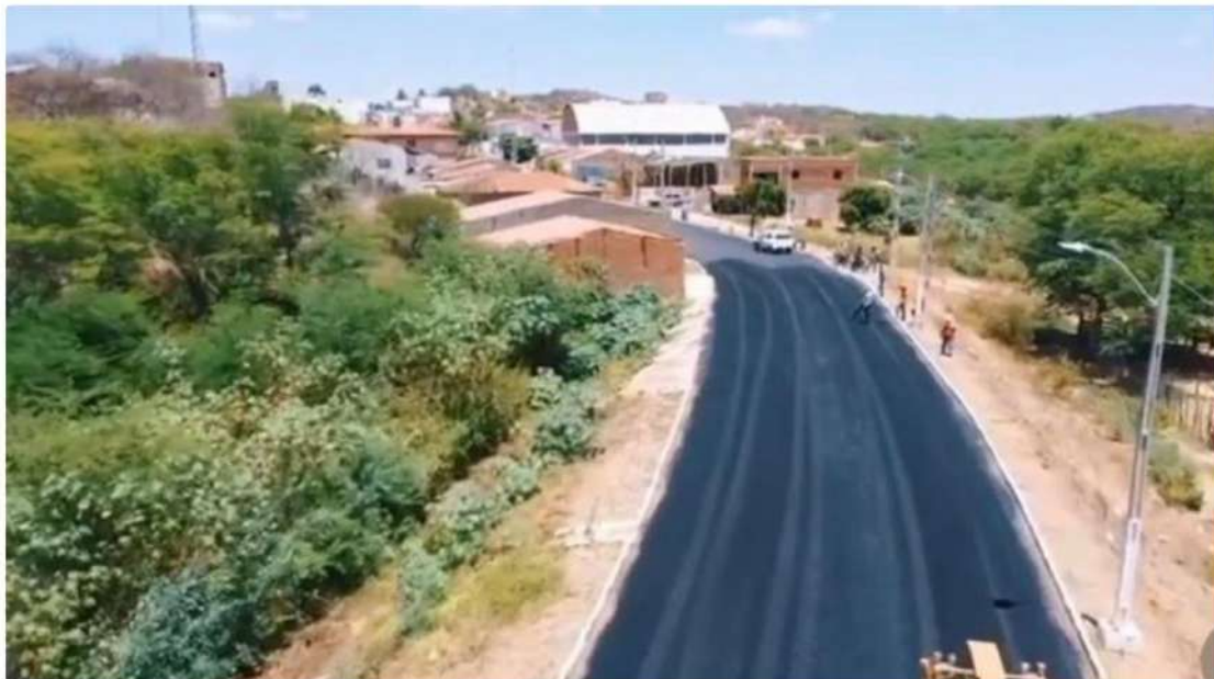
📷 Governo do Estado inicia pavimentação asfáltica da travessia urbana de Camalaú e prefeito comemora
